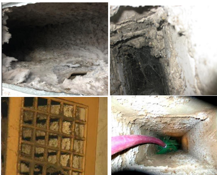
Figura 3. Înfundarea canalului de ventilație [3]
