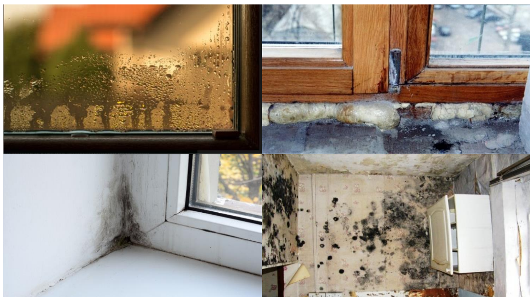
Figura 1. Condensat pe geam, punctelor negre pe rama ferestrei, mușgaiului pe pereți, în colțuri și în spatele mobilei [1]
