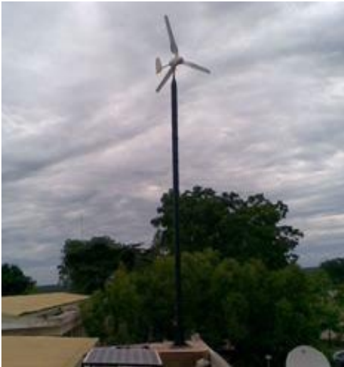
Fig. 3.29. Panoul PV și turbina eoliană.
