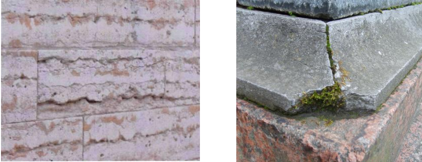
Fig. 6. Distrugerea pietrei de zidărie, exprimată prin prezența microfisurilor, microstraturilor și a substanțelor solubile și de înmuiere
